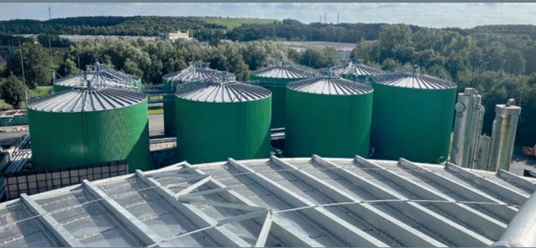
Die Biogasanlage in Dorsten produziert schon seit 2014 Biomethan.
